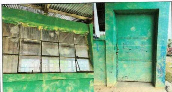
Foto 3: Sustrucción de puertas y ventanas en mal estado.
